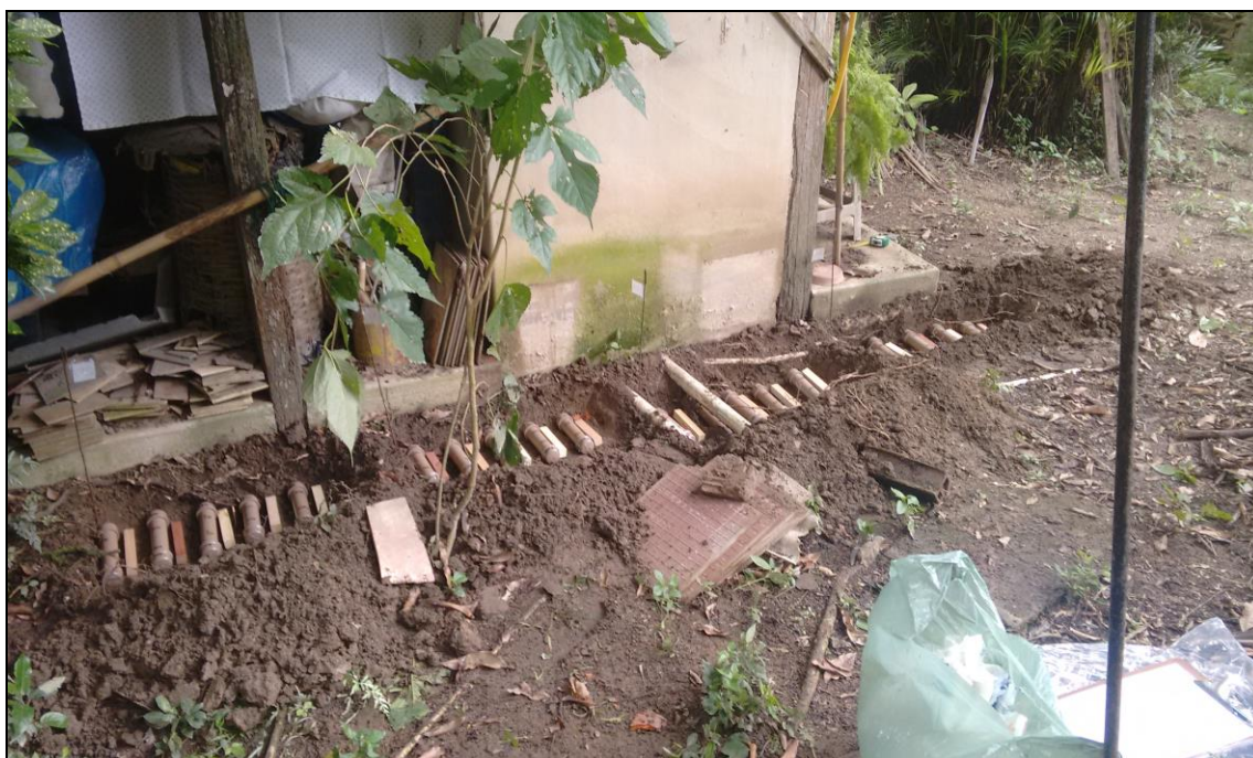
Figura 7. Ponto de atividade termítica na parte externa da residência em Seropédica, Rio de Janeiro.
