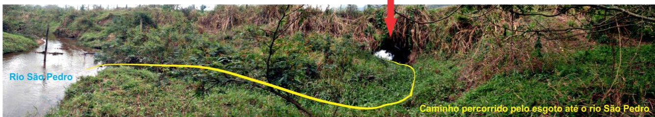
Figura 66: Manilha despejando esgoto no rio São Pedro
