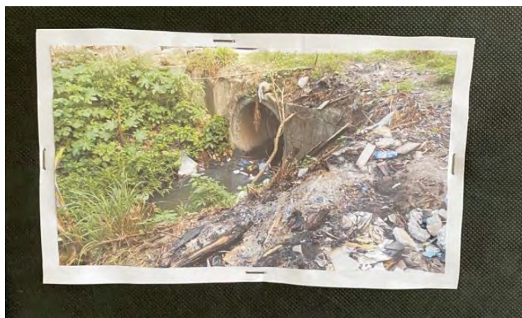
Figura 6 - Esgoto a céu aberto
