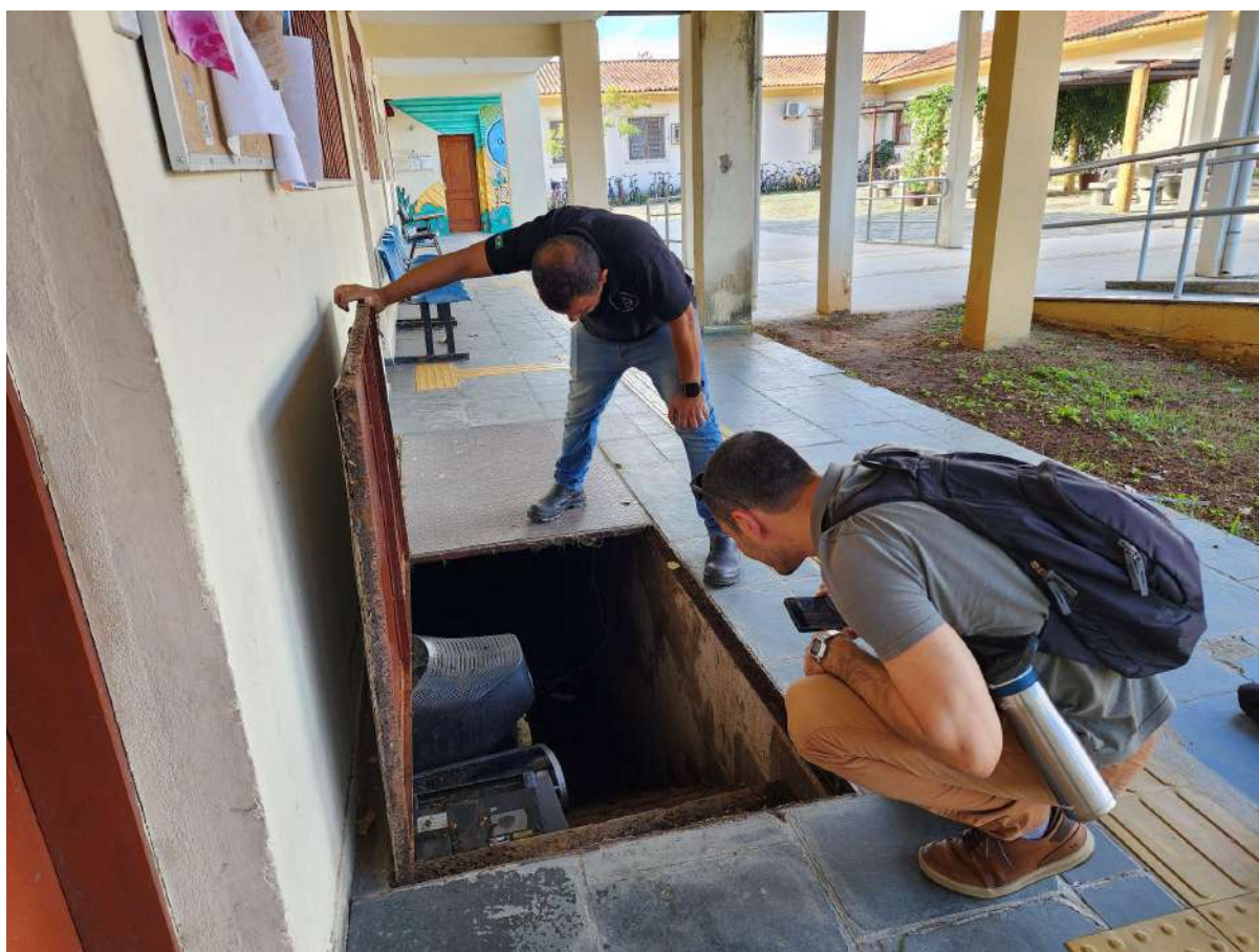
Figura 21: Alçapão com escada para acesso ao subsolo do ICHS/ICSA com diversos resíduos armazenados de forma irregular, inclusive resíduo eletrônico.
