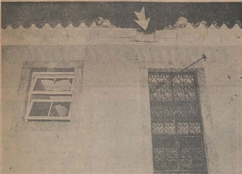
A bomba explodiu sobre o telhado, destruiu telhas e quebrou vidraças
