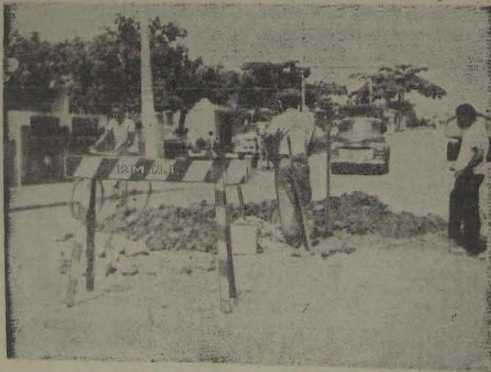
Diariamente, em toda parte do Município, trabalhadores da Prefeitura consertam, limpam as ruas, melhorando o aspecto urbano de Nova Iguaçu.
