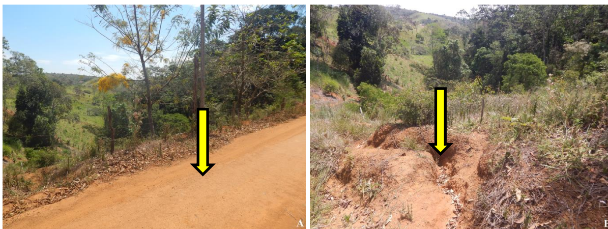
Figura 18. Estrada localizada em APP a montante de uma nascente perene da sub-bacia do Gaviãozinho-Ba, 2018. A - mostra a estrada localizada a montante da nascente nº67. B - mostra a erosão encontrada abaixo dessa estrada
