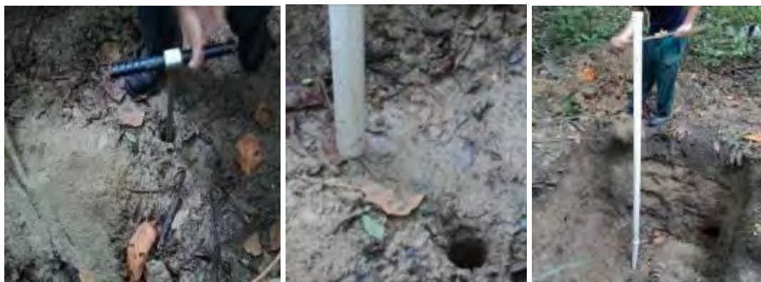
Figura 10: Instalação do poço de observação para leitura da profundidade do lençol freático na área de reflorestamento da UTE Barbosa Lima Sobrinho, em Seropédica, RJ.
