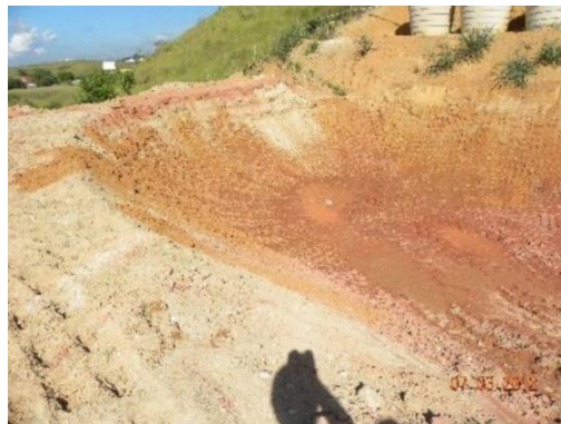
Figura 7 – Tanque de Sedimentação 09, destaque para a inserção de material poroso no fundo do tanque.
