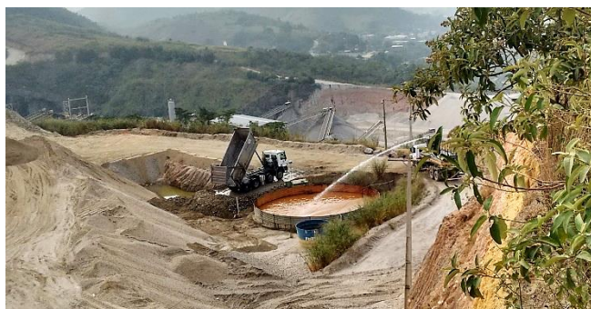
Figura 35 – Tanque Australiano, localizado na cota mais alta de uma microbacia que compõe o Empreendimento, sendo abastecido por caminhão pipa. Este reservatório também recebe água por sistema de tubulação proveniente das captações instaladas no exutório da microbacias.
