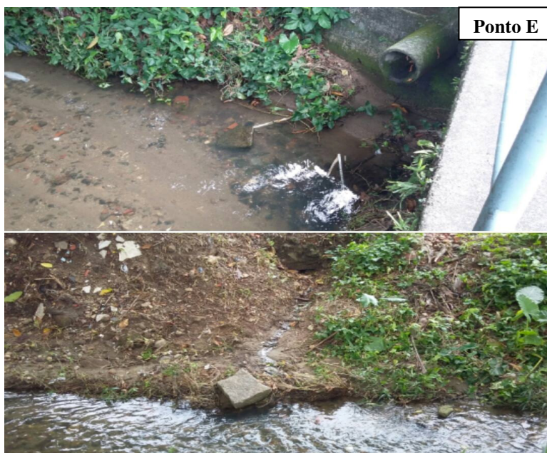
Figura 34: Tubulação desaguando e filete de esgoto em canal – Distrito de Itacuruçá.
