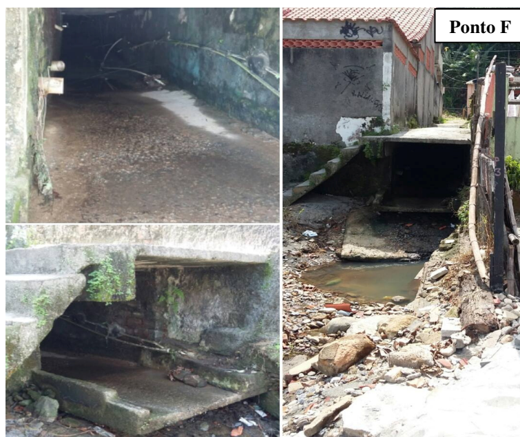
Figura 35: Tubulações desaguando e filete de esgoto na areia da praia – Distrito de Itacuruçá.
