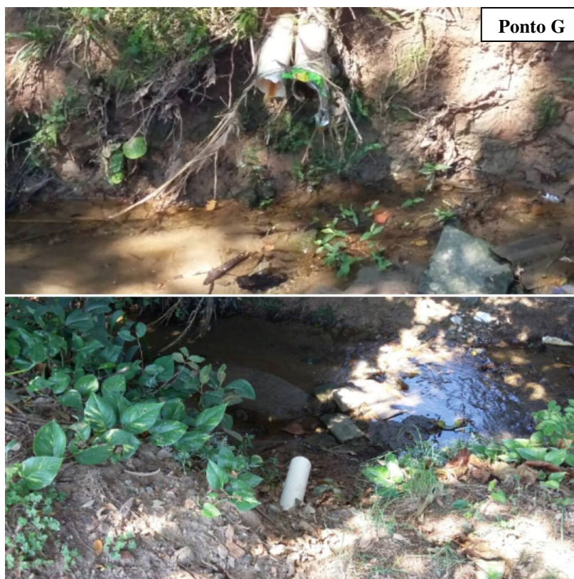
Figura 36: Tubulação desaguando e filete de esgoto em canal – Distrito de Praia Grande.
