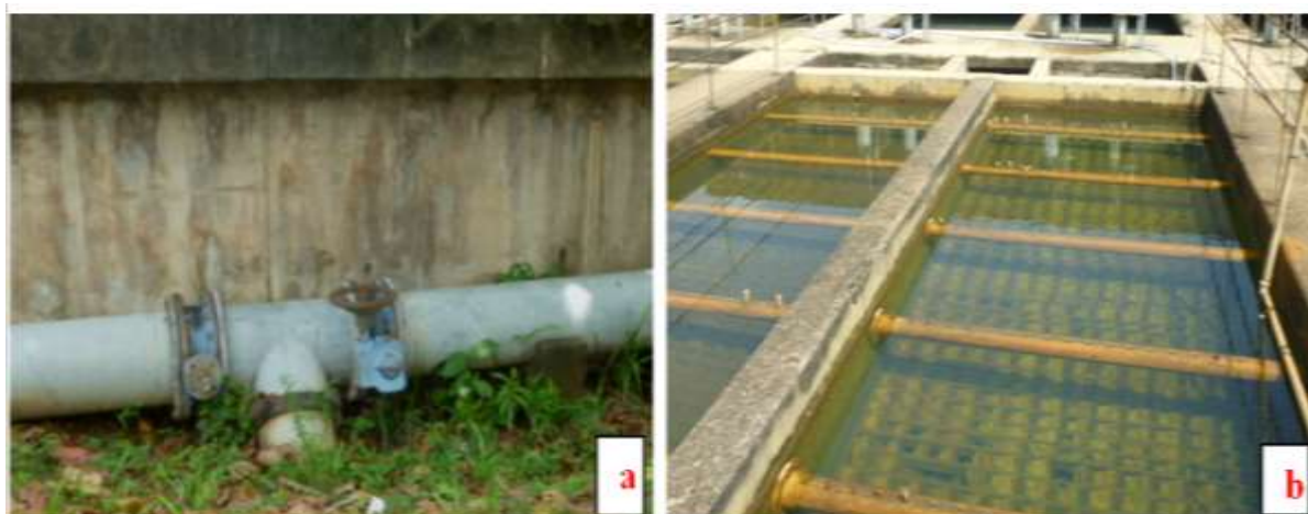
Figura 2a e b: (a) Tubulação que conduz 450m 3 de água por hora do rio Jari para a Estação de Tratamento de Água – ETA durante todas épocas do ano; (b) A ETA trata 675m 3 de água por dia, e quando inaugurada na década de 90 supria a necessidade da população de Laranjal do Jari, porém atualmente insuficiente devido o crescimento da população. A ETA economiza mais insumos durante o verão, porque a água bruta captada apresenta melhor qualidade. Fonte: Nilzomar Almeida, Chefe de Serviço de Abastecimento de Água, durante a visita técnica. Agosto 2013. Acervo do autor.
