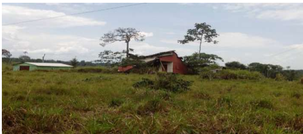
Figura da Escola Rural Estadual deteriorada
