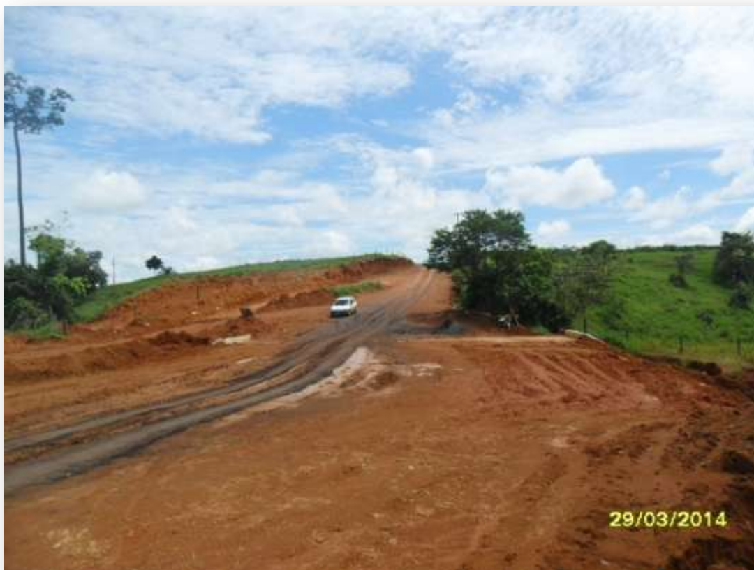
Figura 09: Visão Parcial da Estrada de Acesso sem Asfalto, em 29/03/2014.
