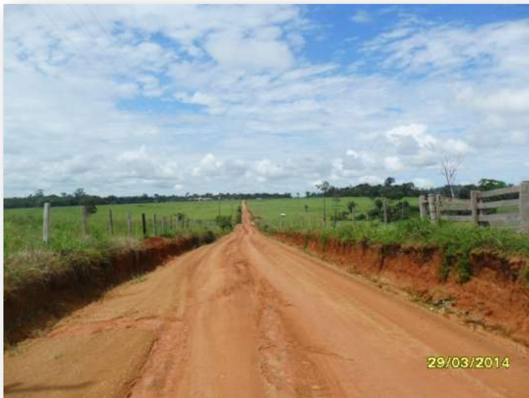
Figura 12: Visão Parcial da Estrada de Acesso sem Asfalto, em 29/03/2014.
