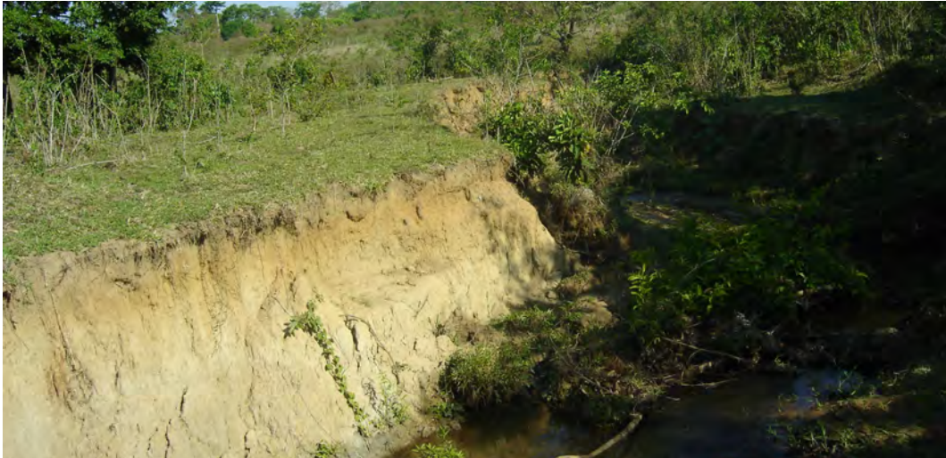
Figura 4: Desbarrancamento do talude do rio Hermes. Fonte: Aquino e Silva (2011)
