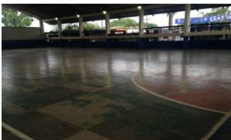
Imagem 3 – Quadra João da Silva Nery. Situação da Iluminação da quadra.
