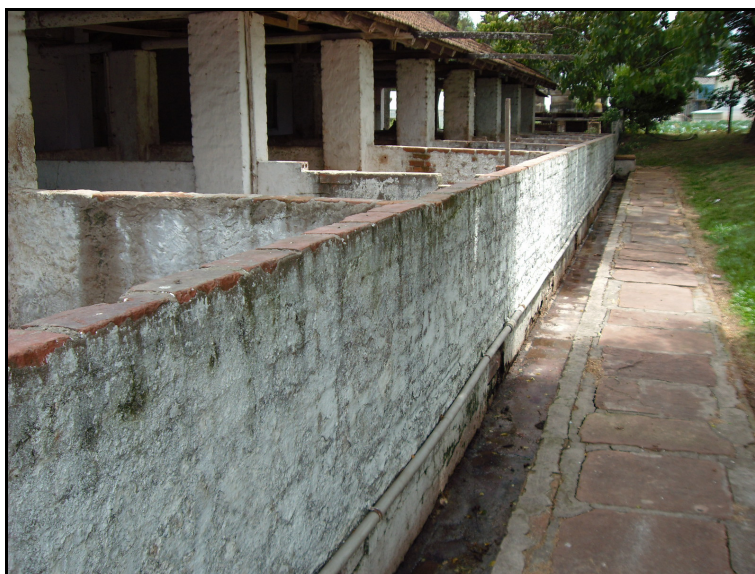
Figura 15 – Canaletas, a céu aberto, no galpão dos cachaços.
