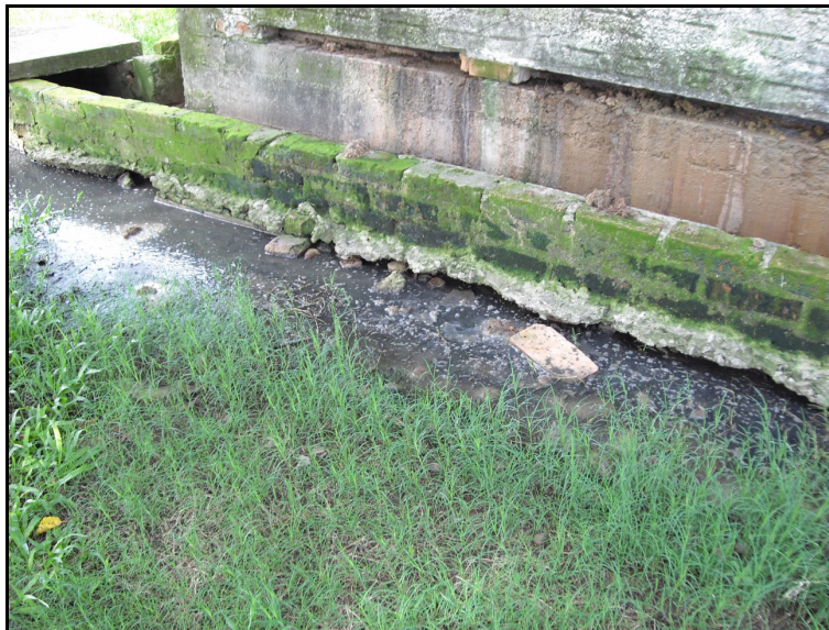
Figura12 – Canaletas, a céu aberto, e vazamentos causando poluição do solo.
