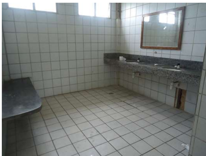
Figura 7. Instalações Sanitárias. Acervo Pessoal
