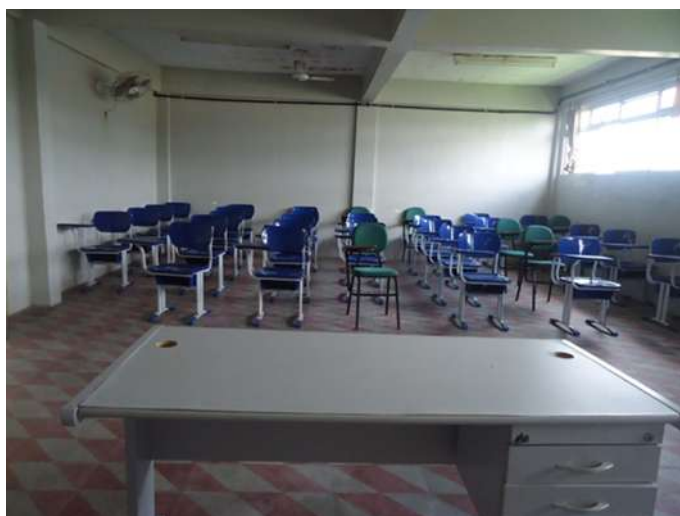
Figura 9. Sistema de refrigeração (ventiladores) em sala de aula. Acervo Pessoal
