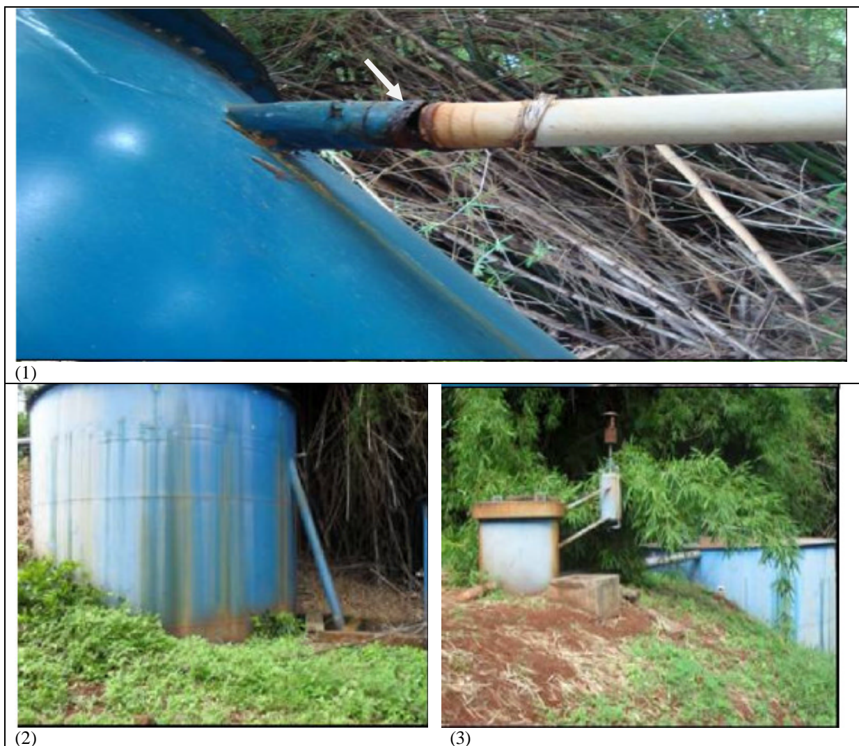
Figura 4.4: (1) Tubulação do sistema de esgoto danificado; (2 e 3) Reator biológico.
