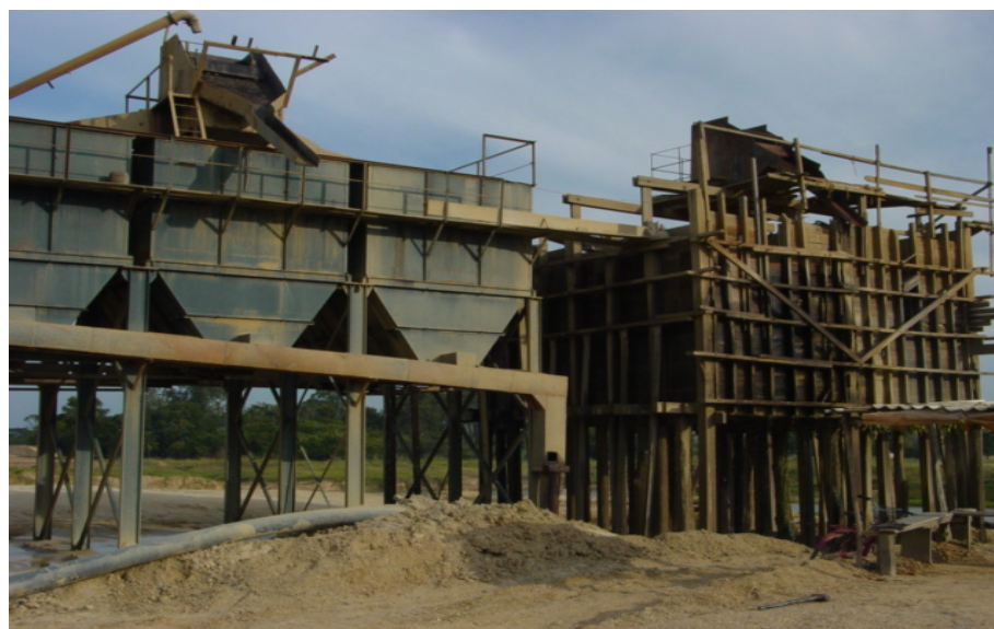
Figura 2: Caixa de lavagem de areia
