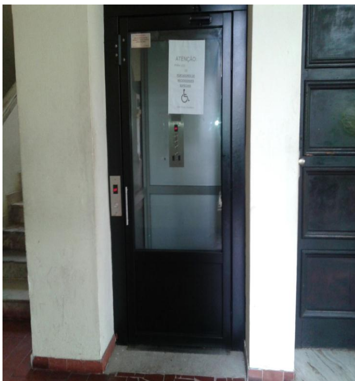
Figura 10: Elevador de acesso ao 2º e 3º andares
