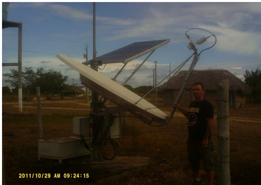
Figura 14 - Paine solar usado em telecomunicações aldeia Campo Alegre (RR). Fonte: Calil Lataiff (2013).
