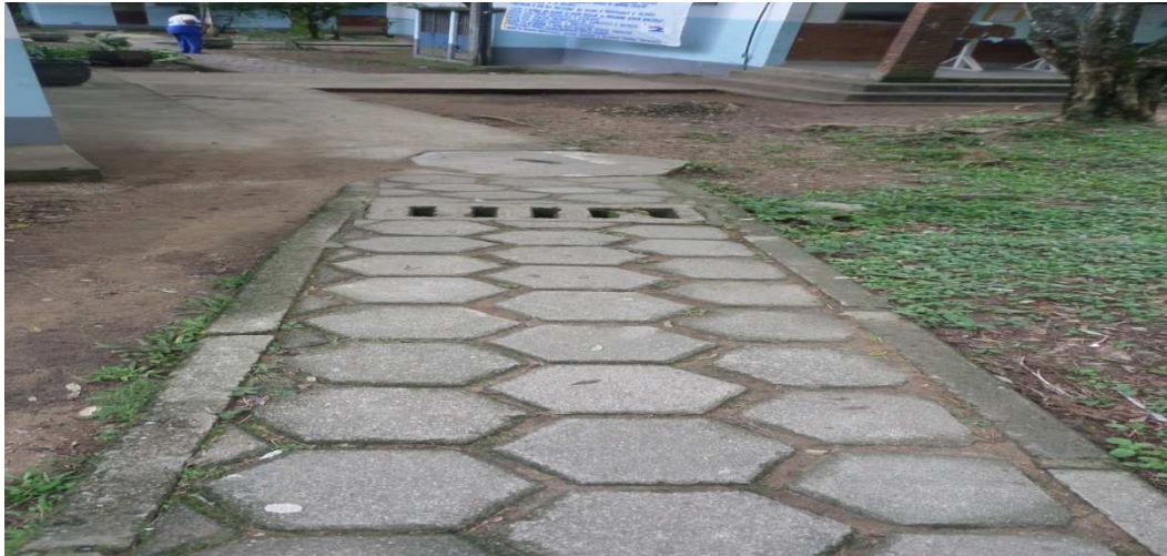
Figura 7. Rampa de acesso ao pavilhão 1 e salas de aula. Fonte: A autora.
