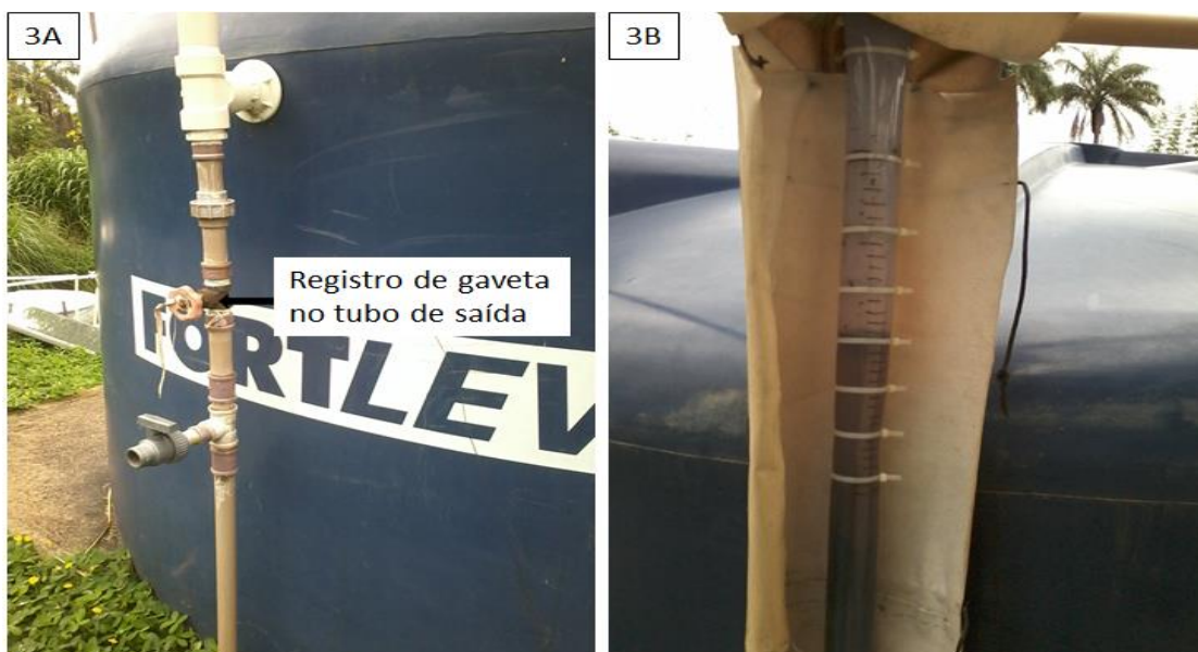
Figura 3. Detalhes do tanque séptico. A: registro de gaveta no tubo de saída do tanque séptico. B: nível da mangueira na face externa do tanque e lona envolvendo o local de sua graduação.
