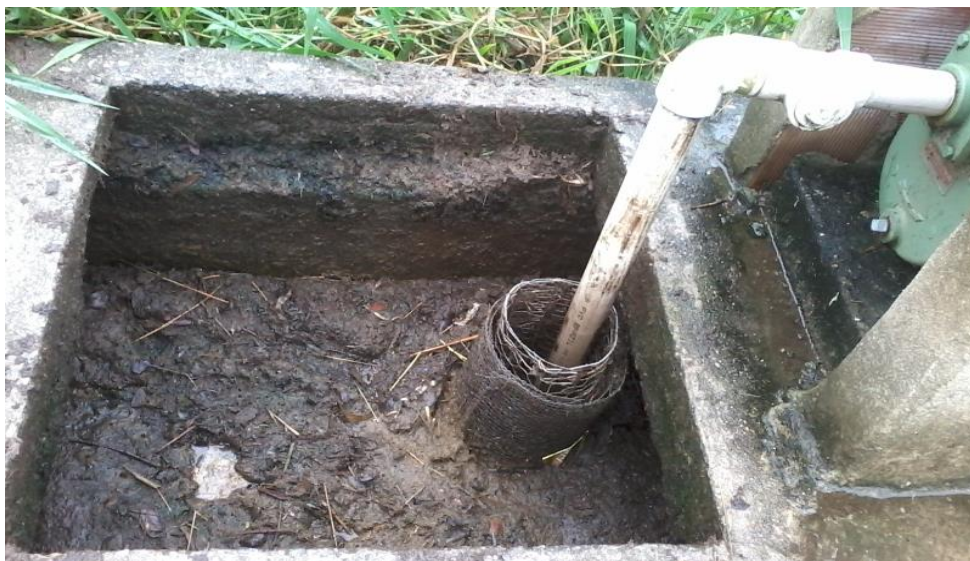
Figura 2. Tela de arame ao redor do tubo de sucção da bomba hidráulica.
