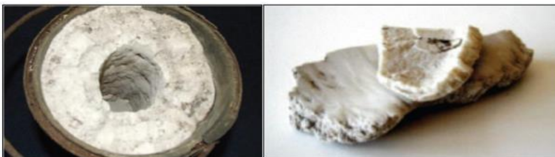
Figura 1: Estruvita precipitada em tubulações de sistemas de tratamentos de efluentes. Fonte: Parsons & Smith (2008).
