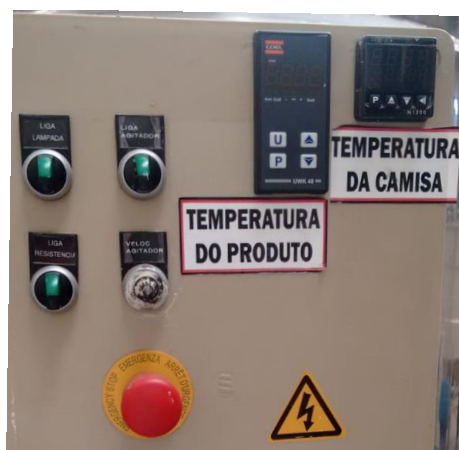
Figura 27. Quadro de controle acoplado ao tanque.
