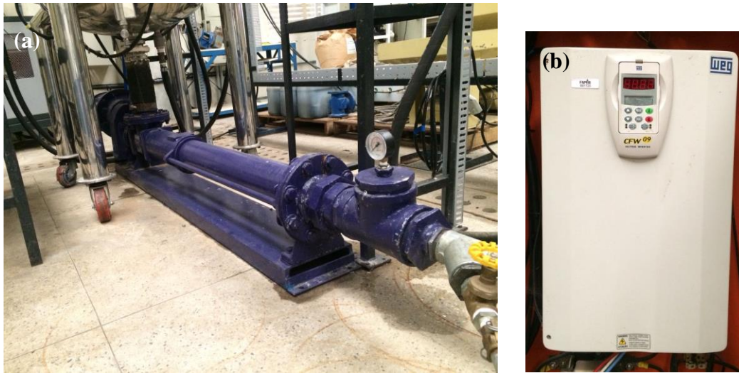
Figura 29. (a) Bomba de deslocamento positivo e (b) inversor de frequência.
