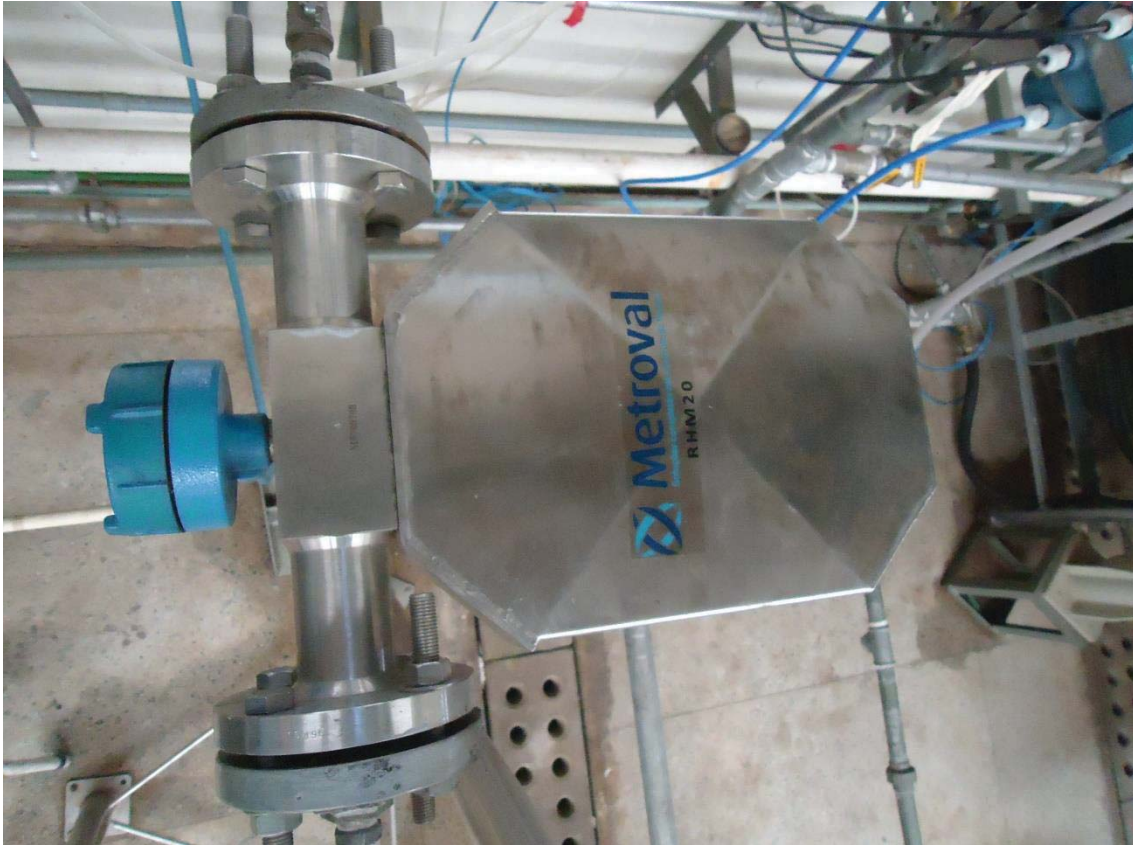
Figura 27 - Medidor de vazão do tipo coriolis. Fonte: O autor.
