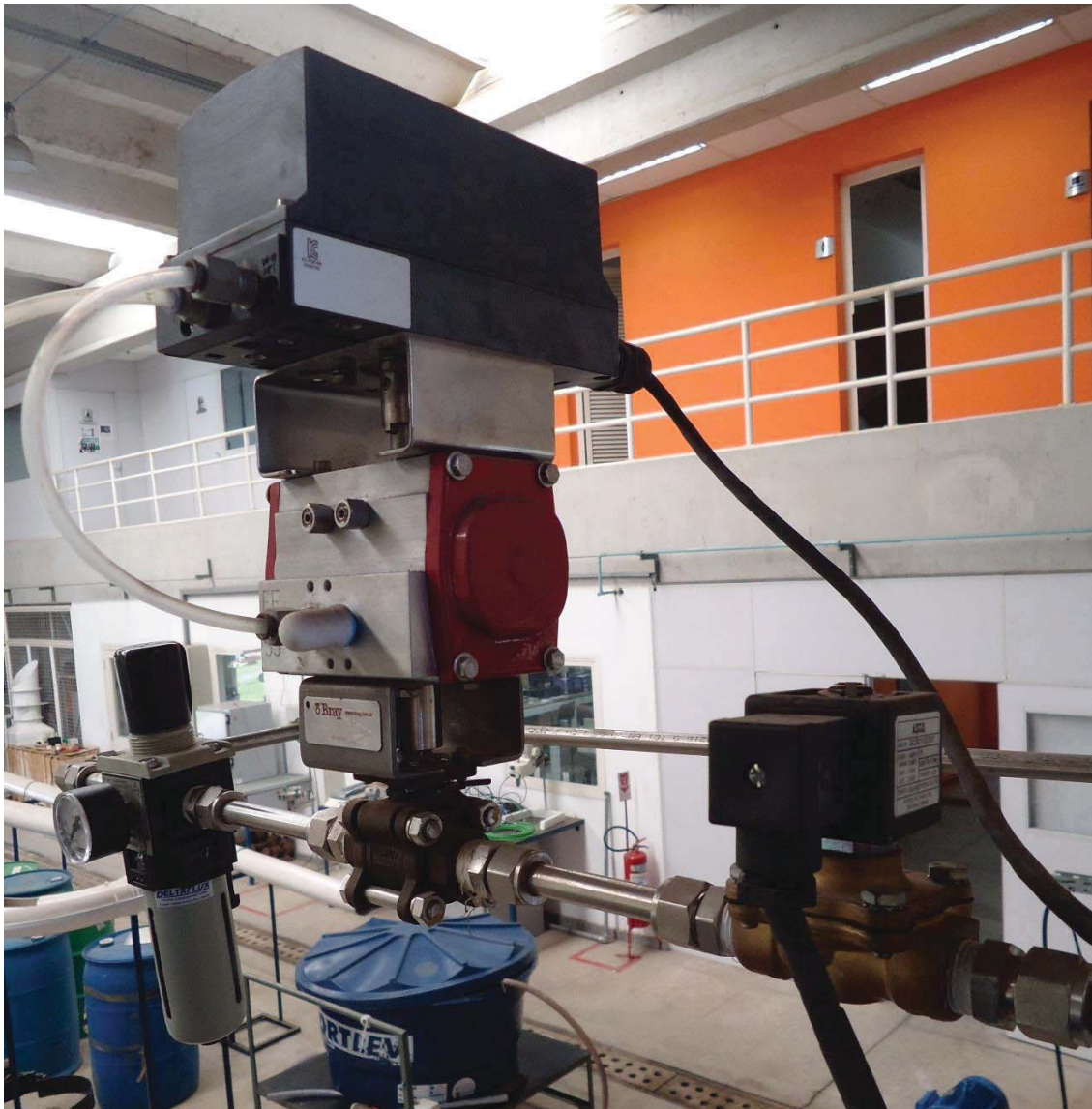
Figura 30 – Conjunto de válvulas que regulam a entrada e saída de ar do reservatório para o controle da pressão. Fonte: O autor.
