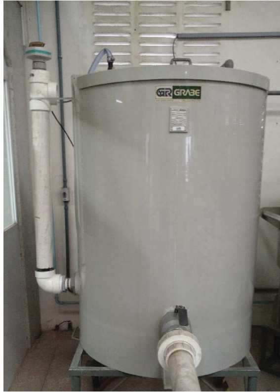
Figura 23 - Tanque de nível. Fonte: O autor.
