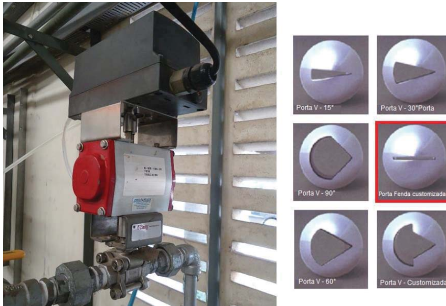
Figura 34 – Válvula reservatório e seu tipo de interno. Fonte: O autor.
