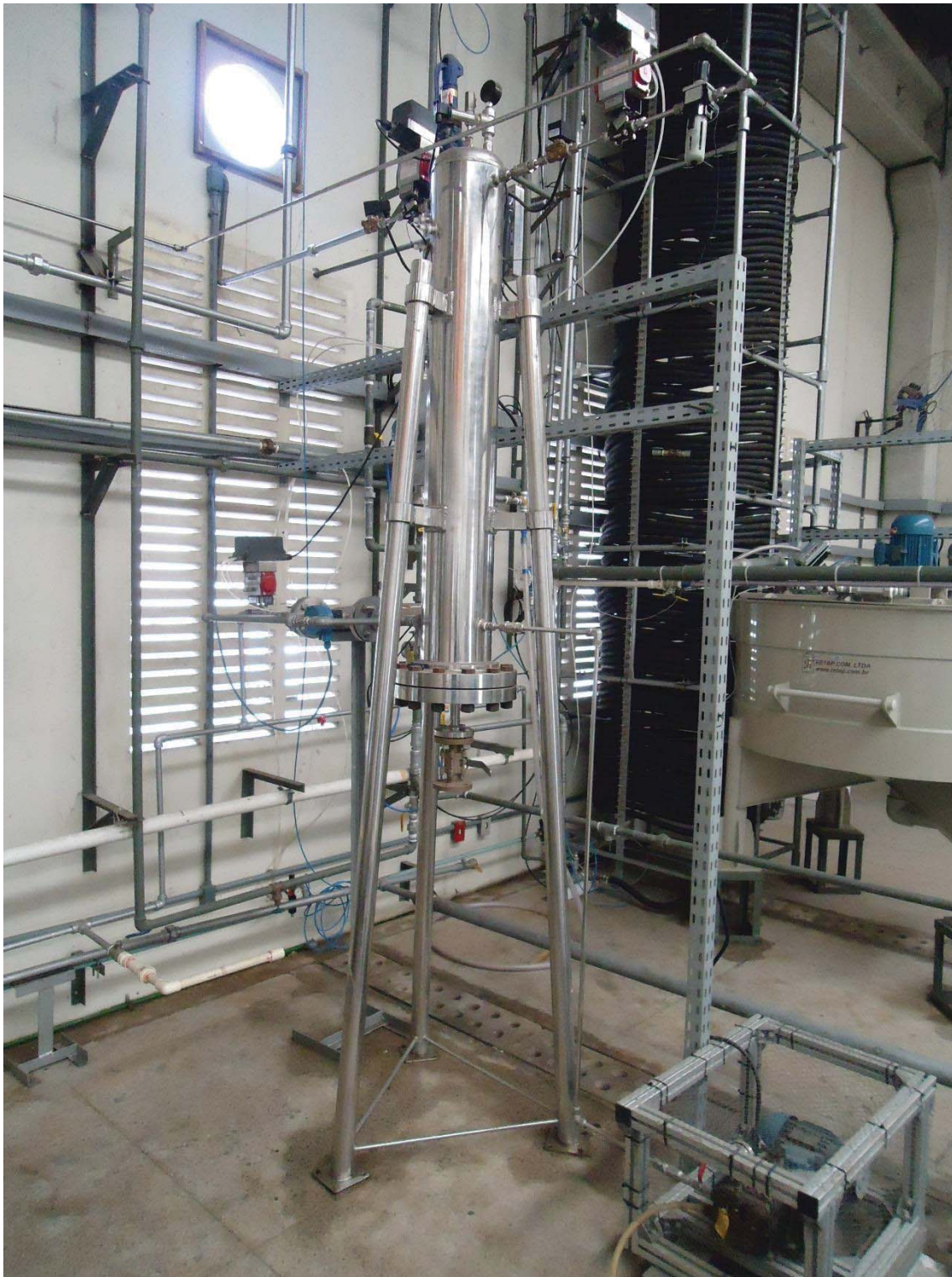
Figura 28 – Tanque reservatório. Fonte: O autor.
