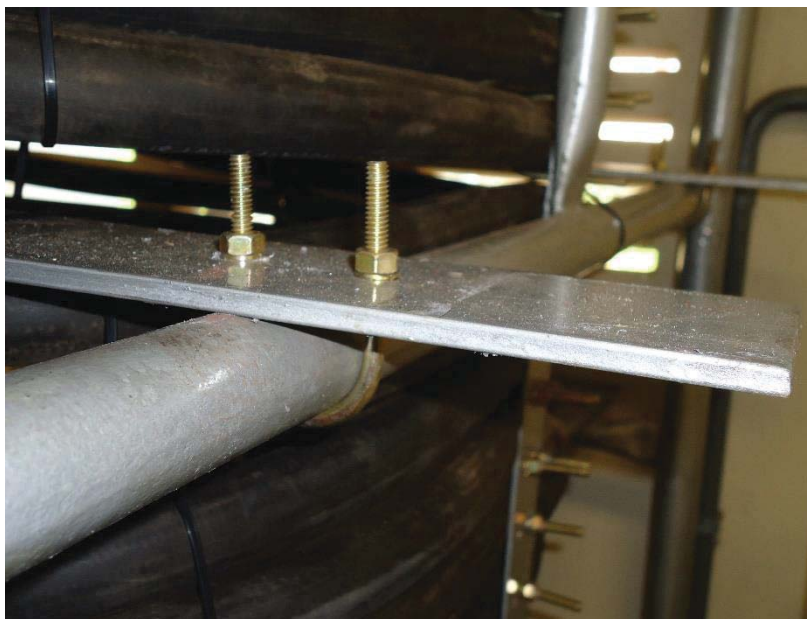
Figura 20 – Barras chatas para evitar o caimento da mangueira. Fonte: O autor.
