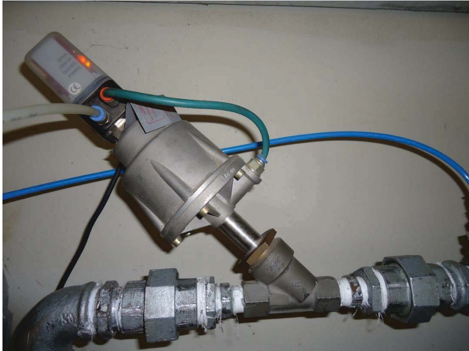
Figura 36 – Válvula choke . Fonte: O autor.
