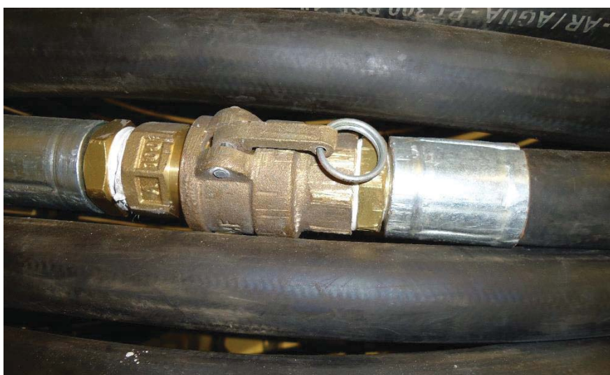
Figura 21 – Conexão prensadas à mangueira e engates rápido. Fonte: O autor.
