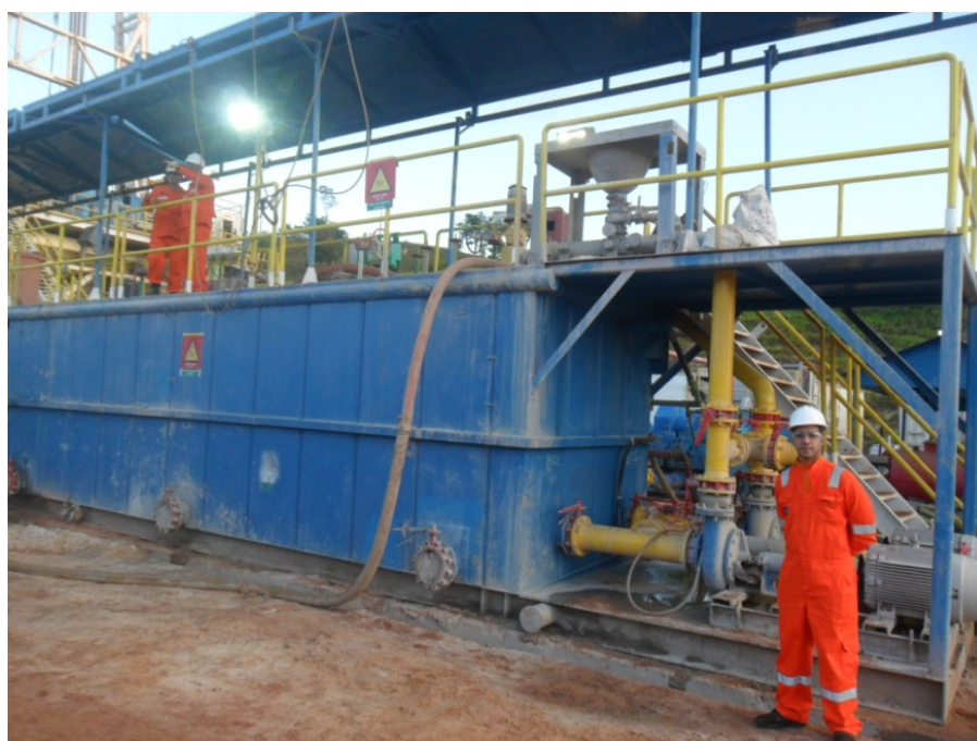
Figura 12. Tanque de produção e armazenamento de fluido de perfuração. Fonte: Acervo pessoal do autor.
