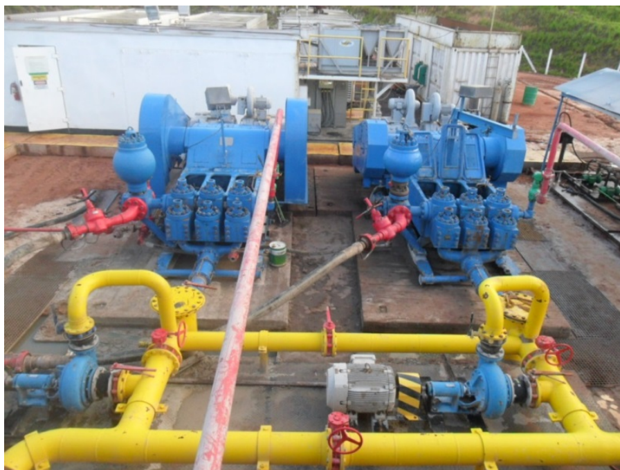
Figura 10. Bombas especiais que admitem os fluidos de perfuração para dentro do sistema coluna/broca. Fonte: Acervo pessoal do autor.
