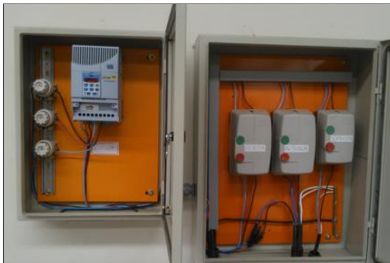
Figura 37 - Foto do inversor de frequência instalado.
