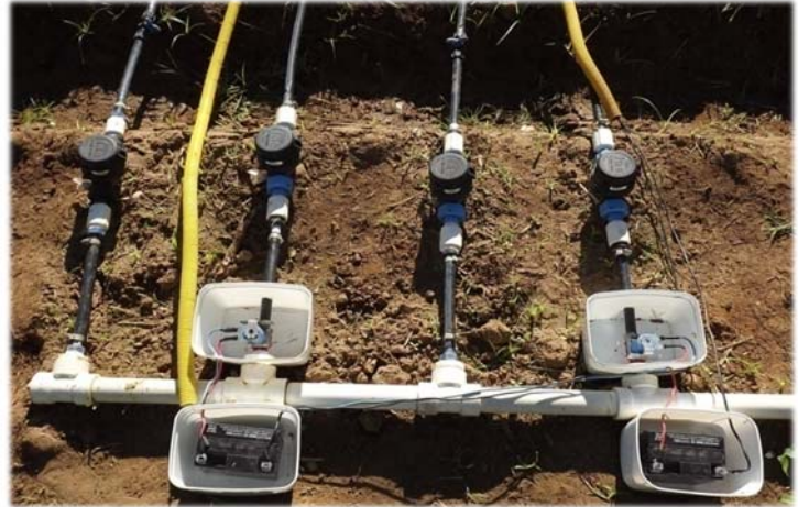
Figura 17: Hidrômetros ao início de cada linha de derivação.
