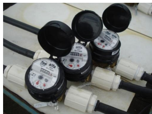
Figura 8. Controle do volume de água por hidrômetros.
