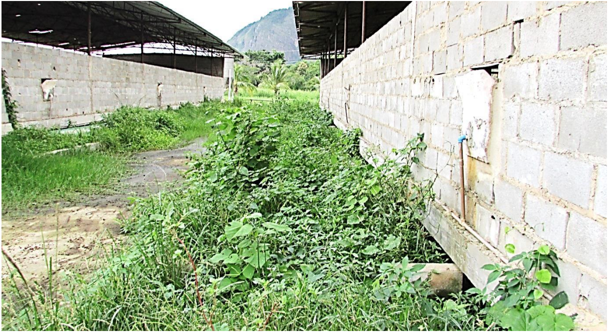
Figura 08: Acesso à parte inferior do galpão para recolhimento de dejetos. Notar o crescimento de vegetação nativa, denotando falta de limpeza por período prolongado. Propriedade no Recreio dos Bandeirantes, Rio de Janeiro. Abril de 2013.
