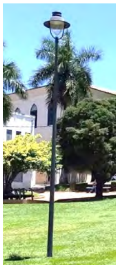
Figura 87: Poste e luminária pública. Fonte: Autor, 2023.
