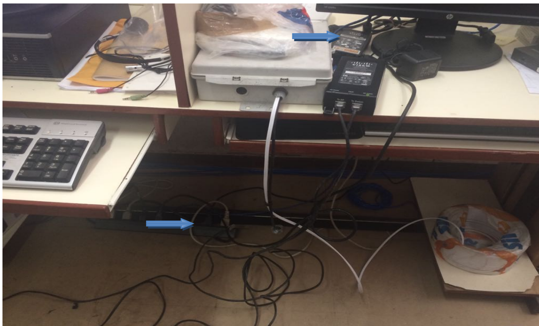
Figura 02: Risco de Acidente na COTIC.
