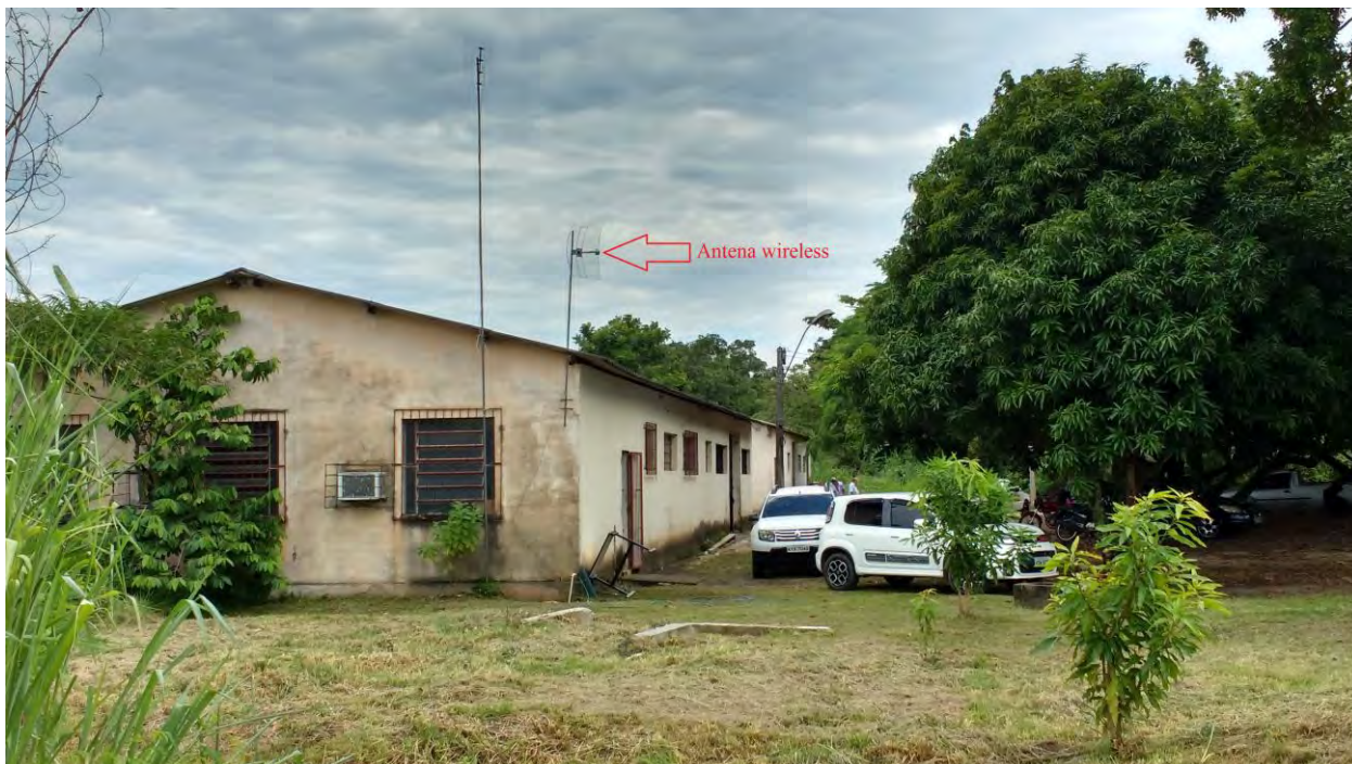
Figura 51. Antena Wireless instalada no Setor de Serviços Comunitários.
