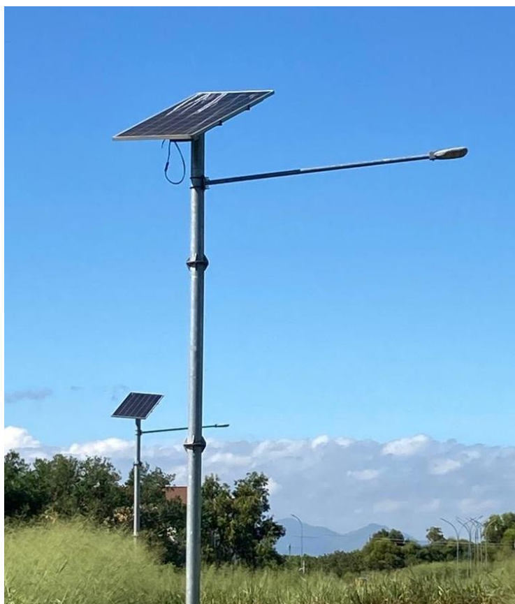
Figura 9: Postes solares com painéis fotovoltaicos no caminho entre o PAT e o RU, no câmpus Seropédica.
