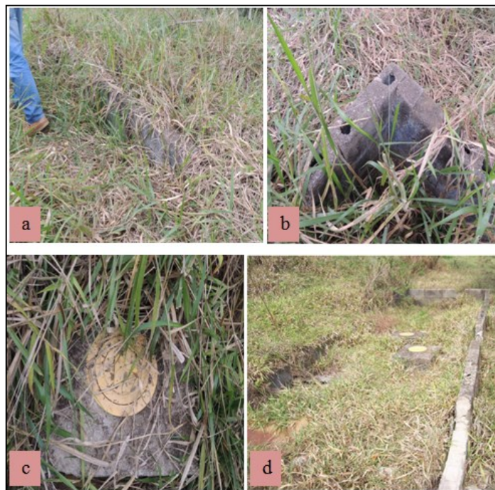
Figura 04: Barreiras de contenção (a, b e d); caixa de sedimentação (c e d). Fonte: Fotos tiradas pela autora em abril de 2016.
