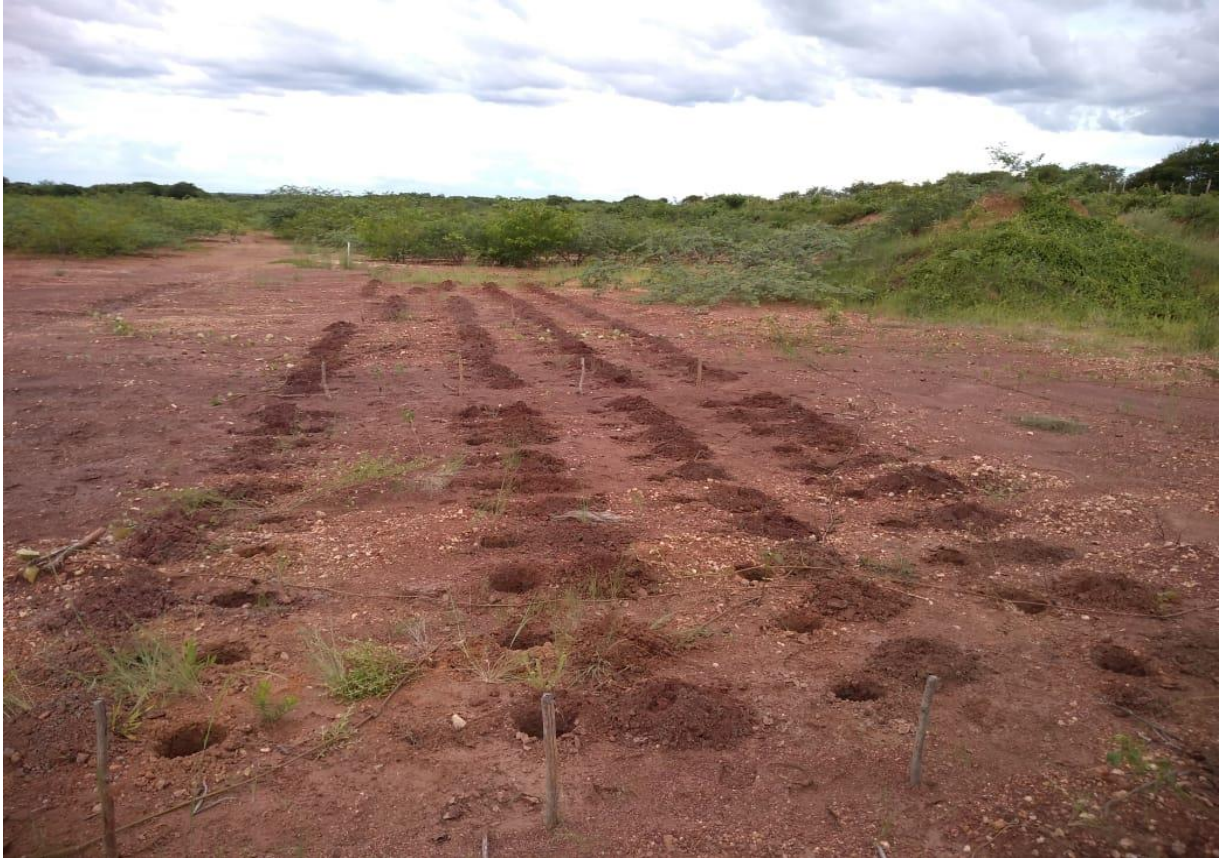
Figura 9: Imagem da área experimental após a abertura dos berços de plantio no espaçamento de 1 m x 0,5 m em jazida de piçarra localizada em Pendências, RN.
