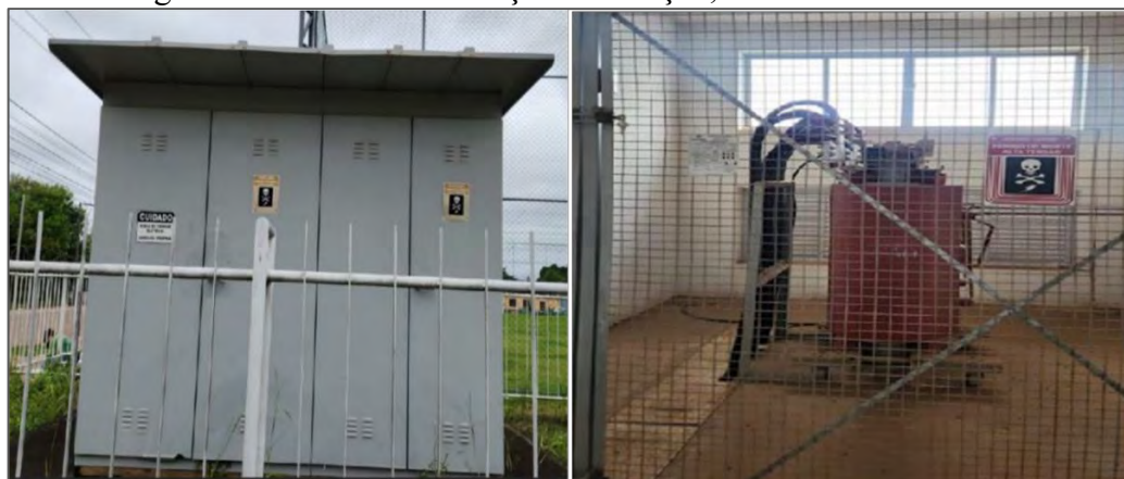
Figura 11 - Cabine de medição e Proteção, e Trafo de 1000kVA
