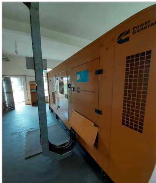
Figura 12 - Gerador de 450kVA
