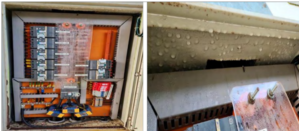
Figura 38 - Condensação QDE Bloco B
