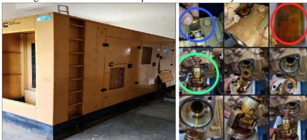
Figura 12 - GMG 450kVA inoperante com a bomba injetora oxidada
