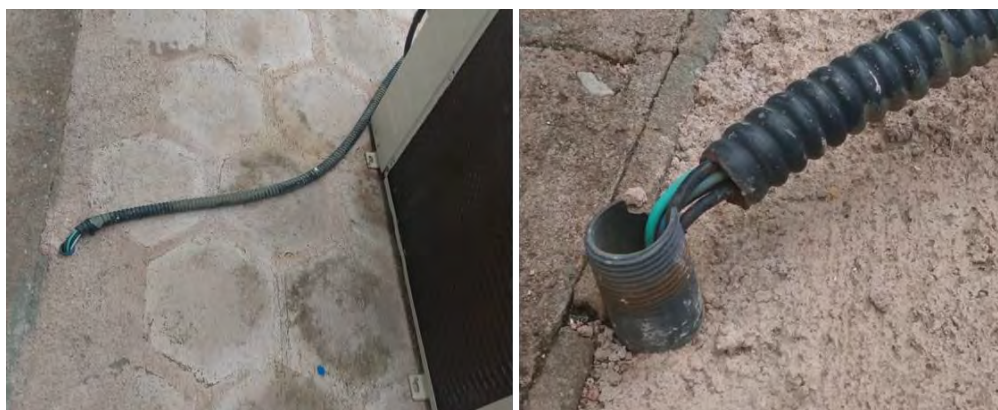
Figura 44 - Cabo de alimentação Central de Ar Sala 06, Bloco B
