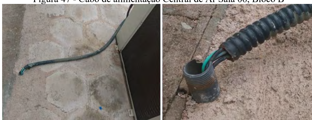
Figura 47 - Cabo de alimentação Central de Ar Sala 06, Bloco B
