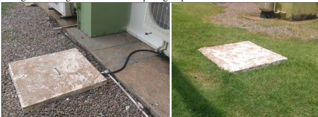
Figura 17 - Algumas das caixas de passagem para cabos elétricos – Bloco B e A
