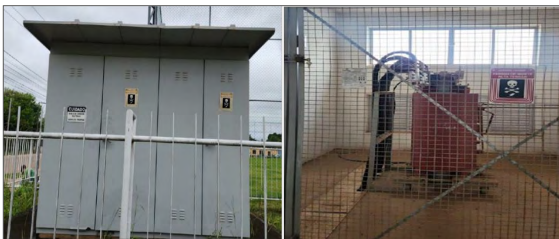
Figura 35 - Cabine de medição e Proteção, e Trafo de 1000kVA
