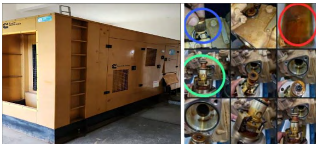
Figura 36 - GMG 450kVA inoperante com a bomba injetora oxidada
