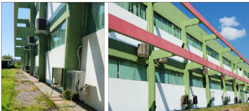
Figura 42 - Splits Bloco C e B
