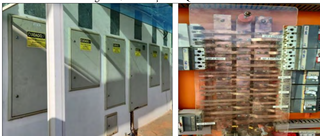
Figura 15 -Oxidação no QDF Bloco C
