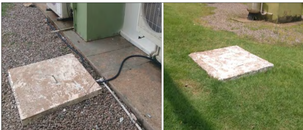
Figura 41 - Algumas das caixas de passagem para cabos elétricos – Bloco B e A
