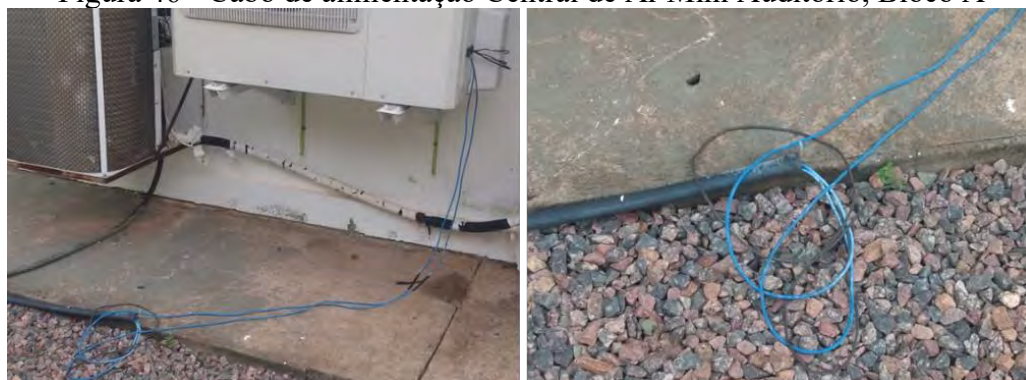
Figura 46 - Cabo de alimentação Central de Ar Mini Auditório, Bloco A
