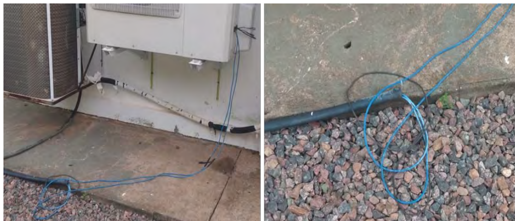
Figura 43 - Cabo de alimentação Central de Ar Mini Auditório, Bloco A
