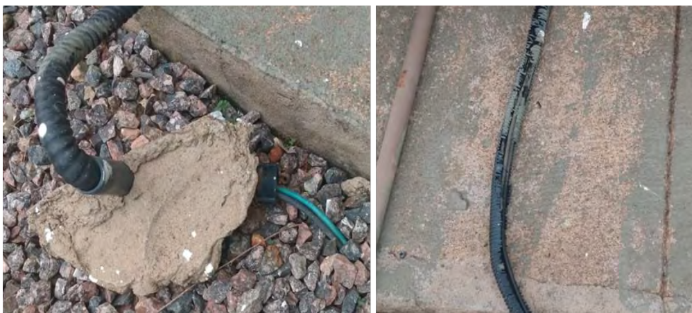
Figura 45 - Cabo de Alimentação Central de Ar Laboratório de Química, Bloco C
