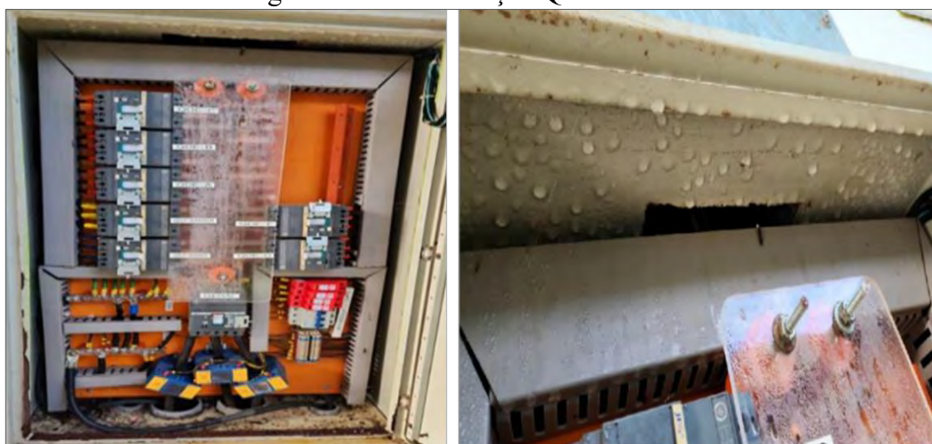
Figura 14 - Condensação QDE Bloco B
