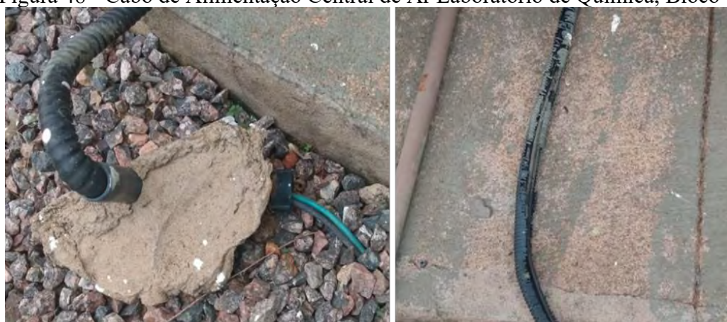
Figura 48 - Cabo de Alimentação Central de Ar Laboratório de Química, Bloco C
