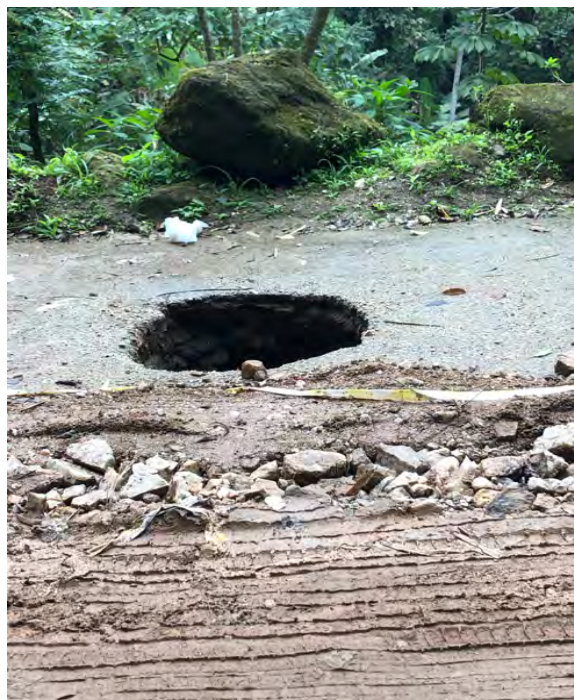
Figura 42 - Trecho da estrada com desabamento
