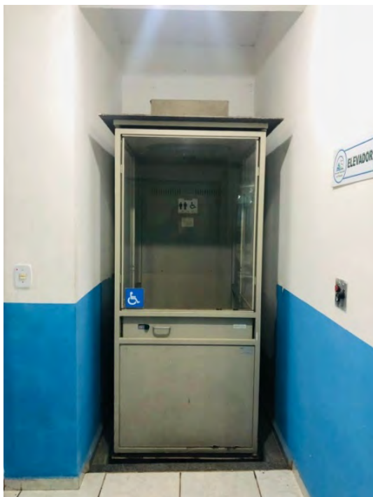
Figura 36 - Elevador para acessibilidade Fonte: arquivo da autora, 2022.
