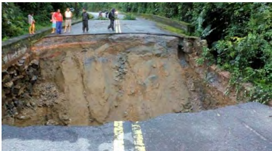
Figura 16 - Trecho da RJ-14 que desabou com as fortes chuvas
