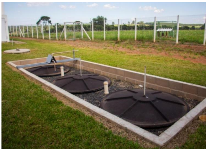
Figura 16 – Fossa Biodigestora instalada Fonte: EMBRAPA, 2017
