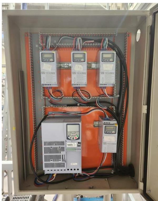
Figura 3.4 Painel de controle com inversores de frequência. Fonte: AUTOR, 2023.
