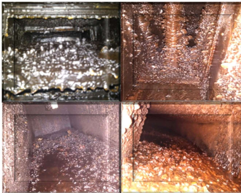
Figura 13 – Acúmulo de gordura em diferentes dutos de exaustão em cozinhas reais.
