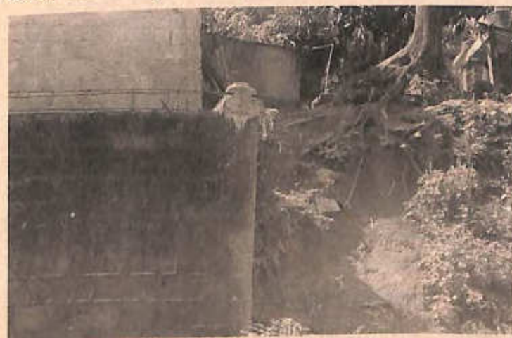
O perigo de desabamento de casas é uma constante no bairro
