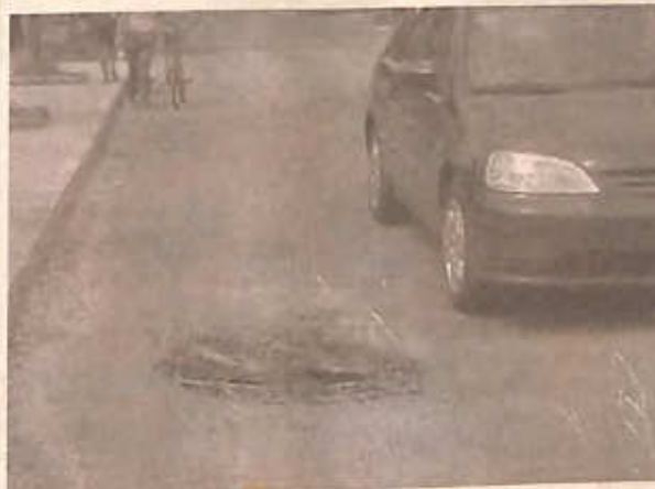
Asfalto da Estrada Principal não durou três meses. Dinheiro público no lixo
