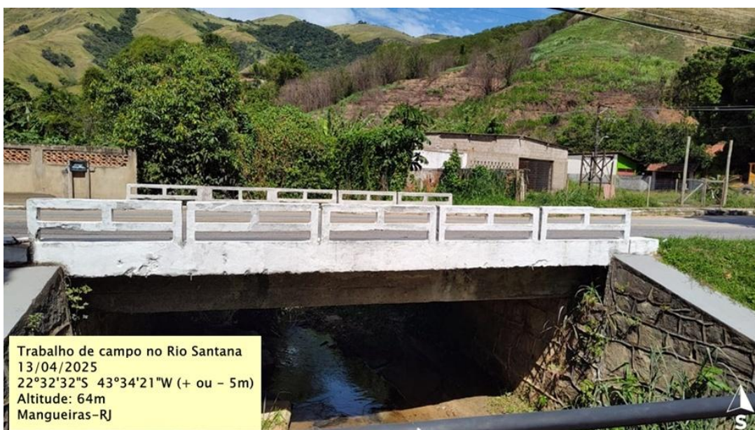
Figura 26: Ponto “d” (bairro Mangueiras-RJ). Construções irregulares
