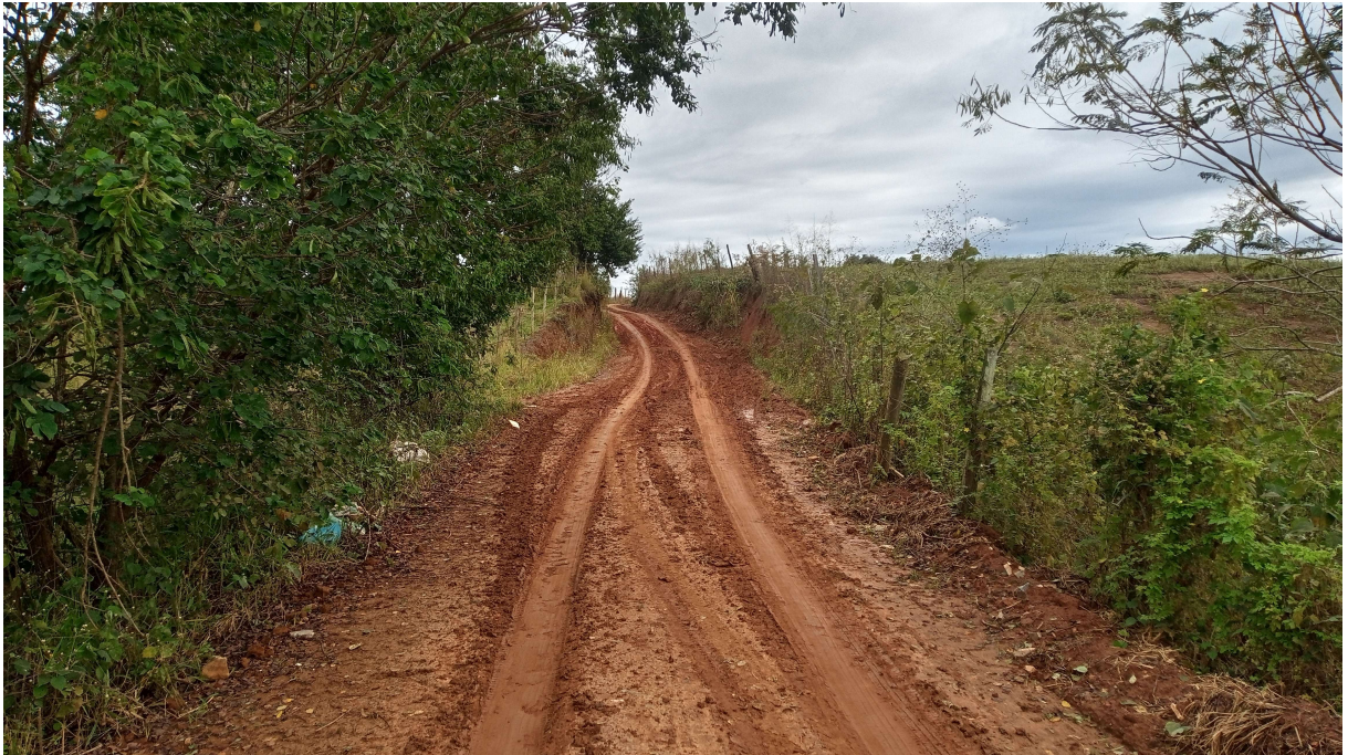
Figura 26- Trecho da estrada Valão da Jabuticaba x Colibri apresentando pista de escorregadia.
