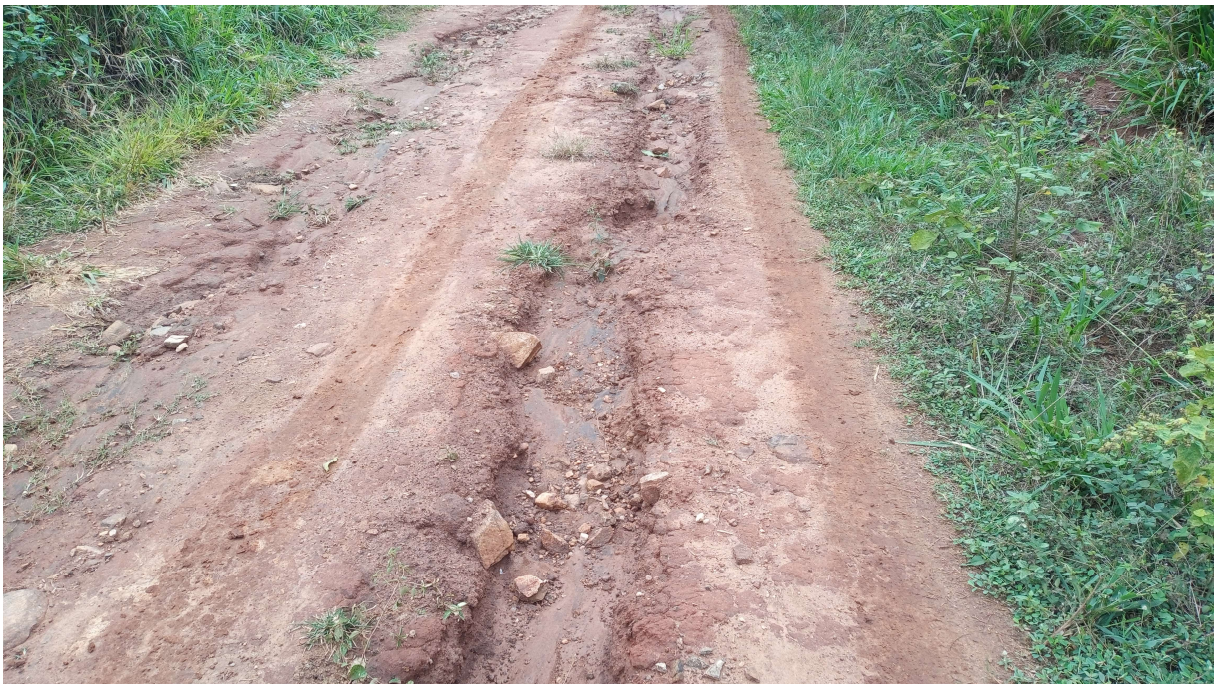
Figura 25- Trecho da estrada Valão da Jabuticaba apresentando erosão em sulcos.
