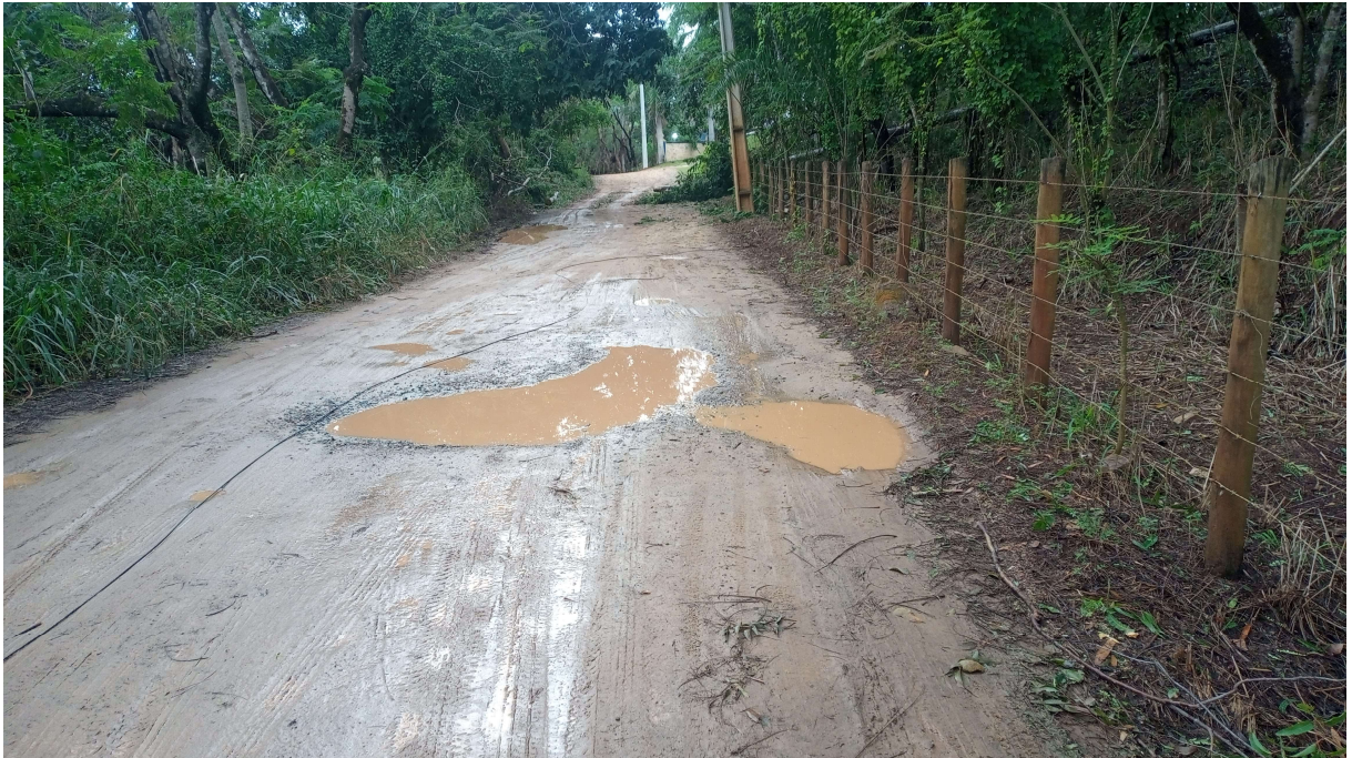
Figura 22- Trecho da estrada Valão da Jabuticaba com a presença de buracos severos.
