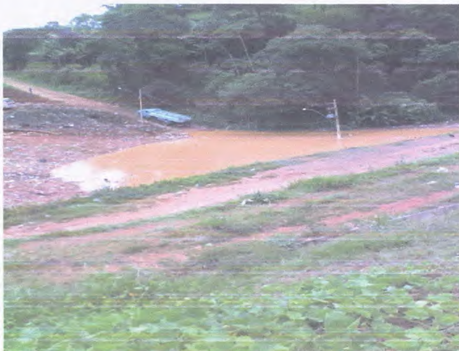
FOTO 1 – Detalhe mostrando o empoçamento de água no aterro sanitário da CTR de Teresópolis após uma chuva intensa ocorrida em março/2010, mostrando a precariedade do sistema de drenagem.
