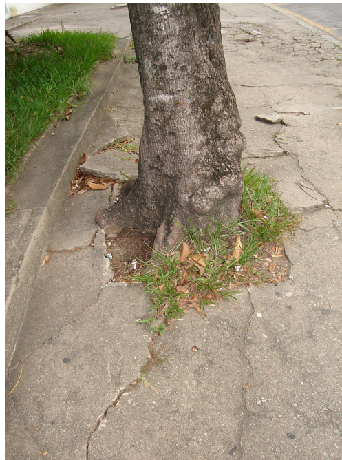
Figura 4: Conflito com o calçamento
