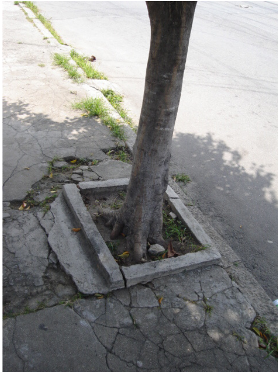
Figura 5: Conflito com o calçamento
