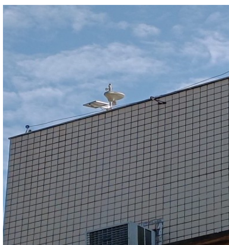
(a) Localização da estação na cobertura do bloco
