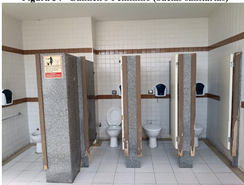
Figura 34 - Banheiro Feminino (bacias sanitárias)
