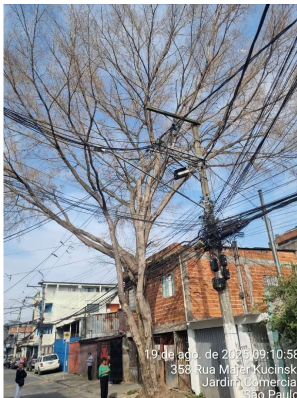
Figura 10 – Ficus Benjamina morta em conflito com a rede de energia (Autor, 2025)
